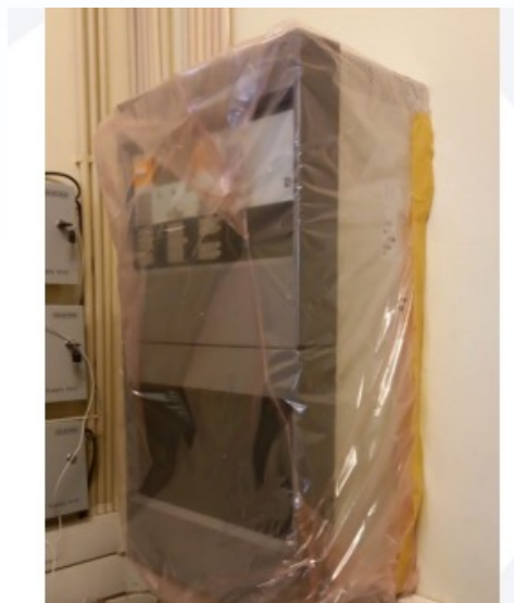
Figura 54: Sistema de Alarme de Incêndio
